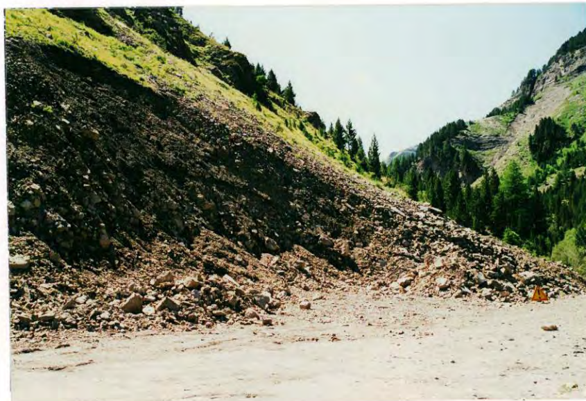
Photo 9 : effondrement d'un talus de route sur la voie carrossable qui mène à la bergerie Rebattu
